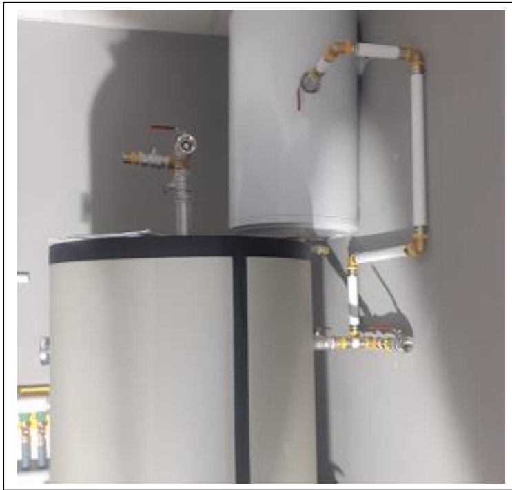
FOTO charger 100 litri installato
